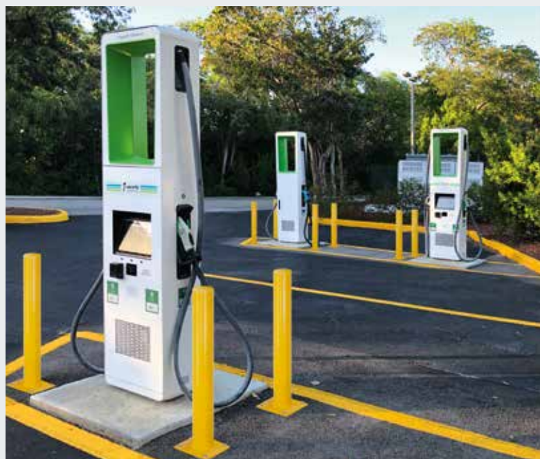
Ochrona instalacji zewnętrznych, np. stacji ładowania pojazdów elektrycznych
